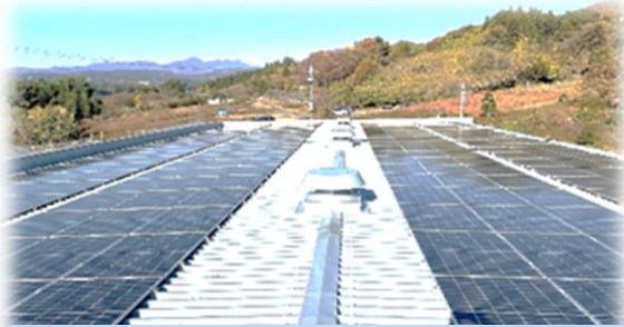
工場屋根全体に太陽光パネル設置
